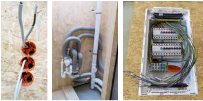
Installationen für Strom und Wasser sind ein Produktionsschritt, der bereits vor dem Aufbau auf der Baustelle erfolgt.
